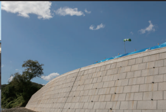
護岸が「壁」となり、水害を防ぐ
