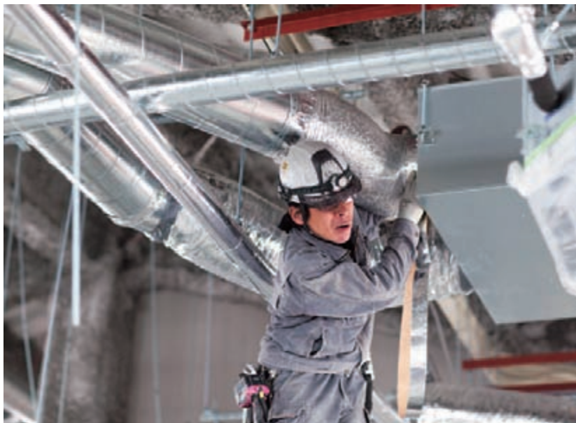
銭湯をはじめとする多機能施設だけに、給湯管などのさまざまな配管が張り巡らされる。
