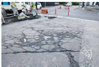
痛みの激しい交差点付近。
