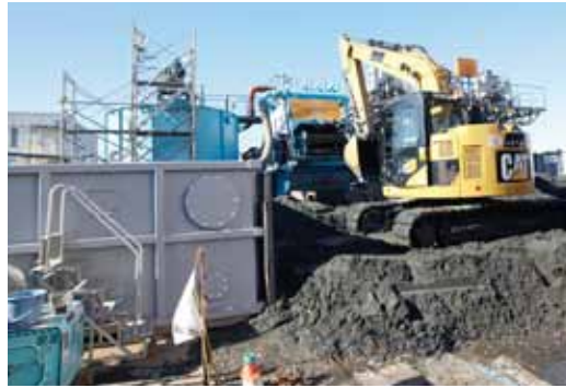
プラントに泥土が運ばれてきて砂と粘土に分別される。
