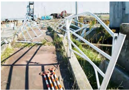
津波の力で折れ曲がった手すり。
