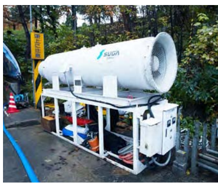
埃や塵が停滞しないようトンネル内に風を送る機械。
