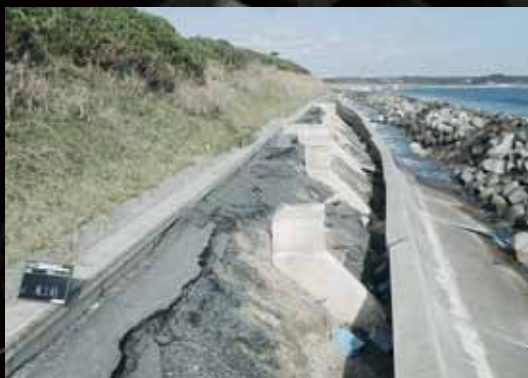
津波で破壊された防潮堤。
