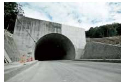
トンネルの右上部分が土砂崩れによって欠けてしまった部分。
