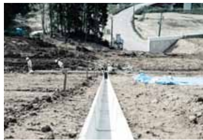
激しい斜面につくられた排水路。
