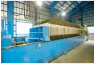
④ 水分を減らす。（脱水機＝フィルタープレス）
